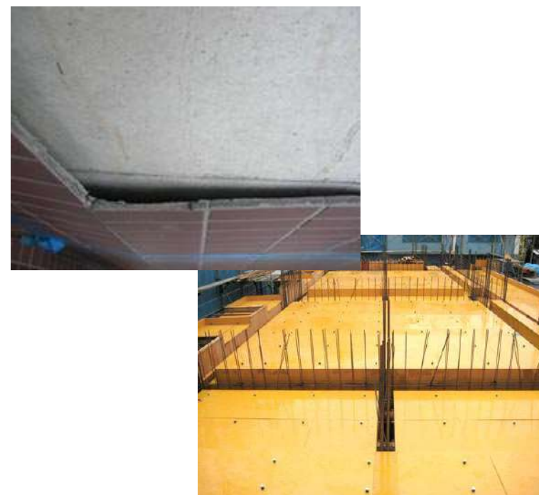
適切に下地処理されていない、平滑な表面のタイル下地【上】 ウレタン塗装がされたコンクリート型枠【下】
